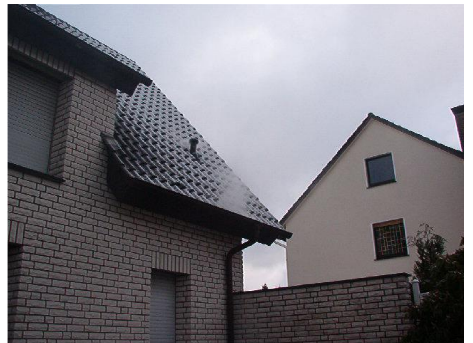
Nebelaustritt aus Entlüfter- und Regenfallrohr: Fehlanschluss an SW-Kanalisation
