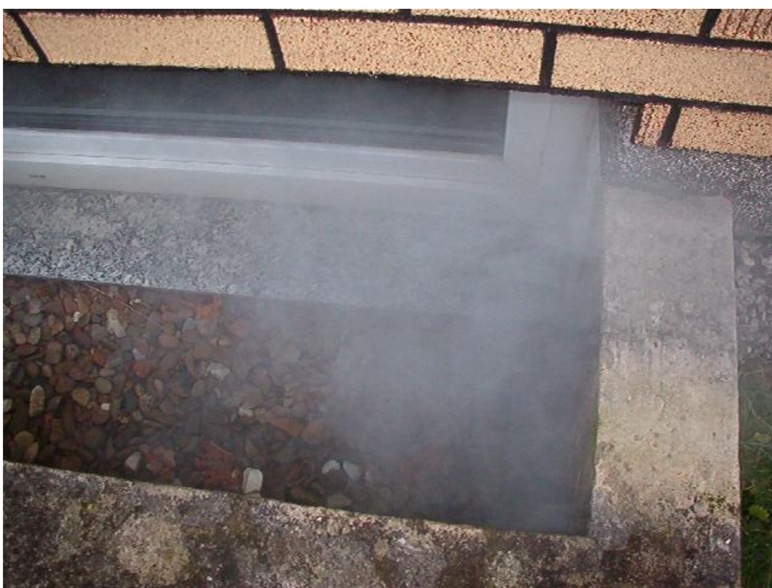
Nebelaustritt bei einem Lichtschacht: Drainagefehlanschluss
